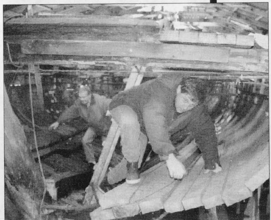
Sekretær Ivar Grindvik i fylkesfiskarlaget er en av de som ser fram til at Søblomsten blir ferdig, men som gleder seg over å følge med i arbeidet. Her kryper han ut av den, foreløpig, åpne hekken.
